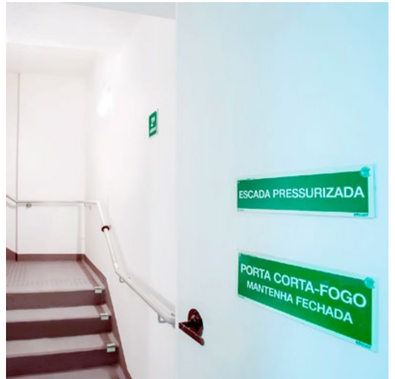
O SISTEMA de pressurização usa ventilação mecânica para injetar ar limpo nas escadas
