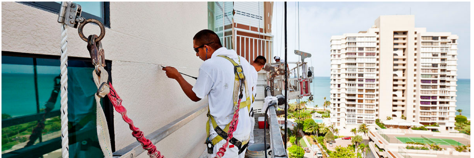
A MANUTENÇÃO PREVENTIVA costuma ter custos menores que a corretiva, pois evita que as estruturas do condomínio sejam afetadas
