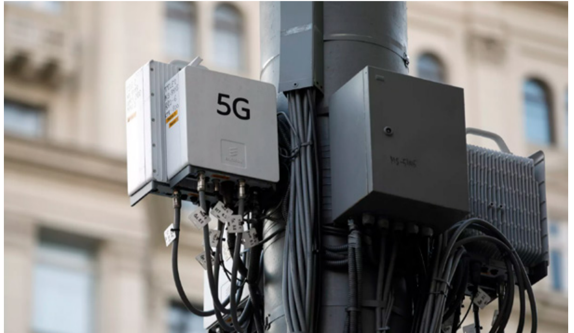
AS ANTENAS 5G podem ser instaladas em postes de iluminação, semáforos e pontos de ônibus
