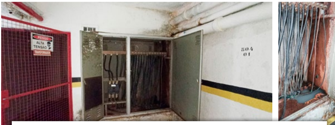
INFILTRAÇÃO próxima ao quadro do sistema elétrico de um condomínio em Florianópolis: o prédio teve de ser interditado e evacuado
