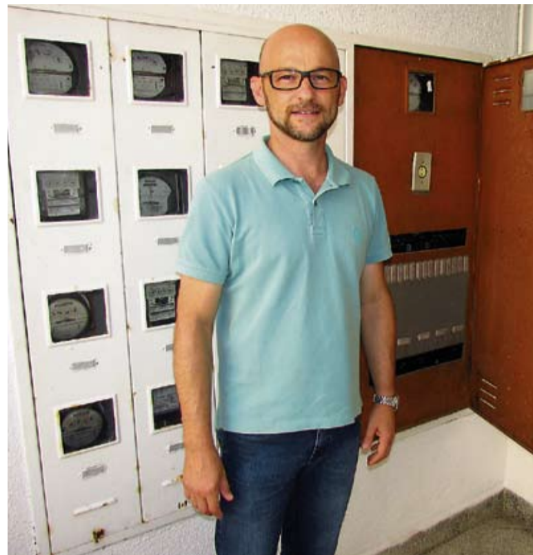
Sindicato Cleverton Maciel: reclamação de queda de energia nos apartamentos foi o sinal de que estava na hora de reformar os sistemas elétricos do condomínio
