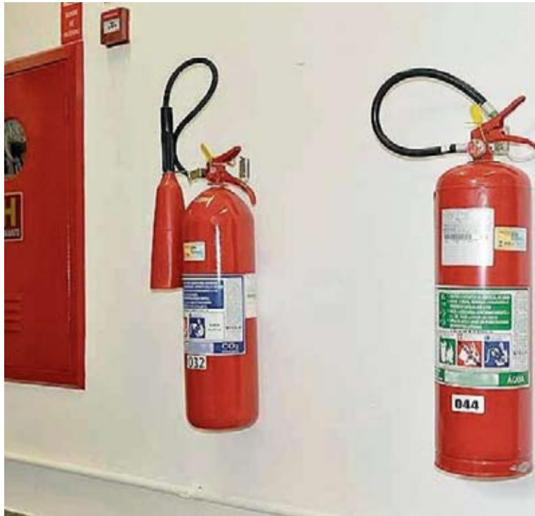
O sistema de prevenção contra incêndios do condomínio deve passar pela aprovação do Corpo de Bombeiros
