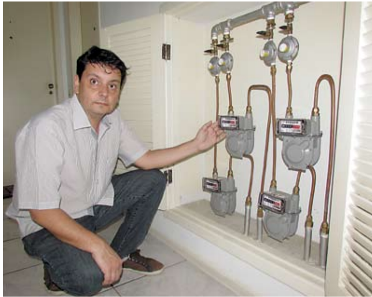
Síndico Carlos Brasil providenciou a troca dos medidores de gás no Residencial Marbella
