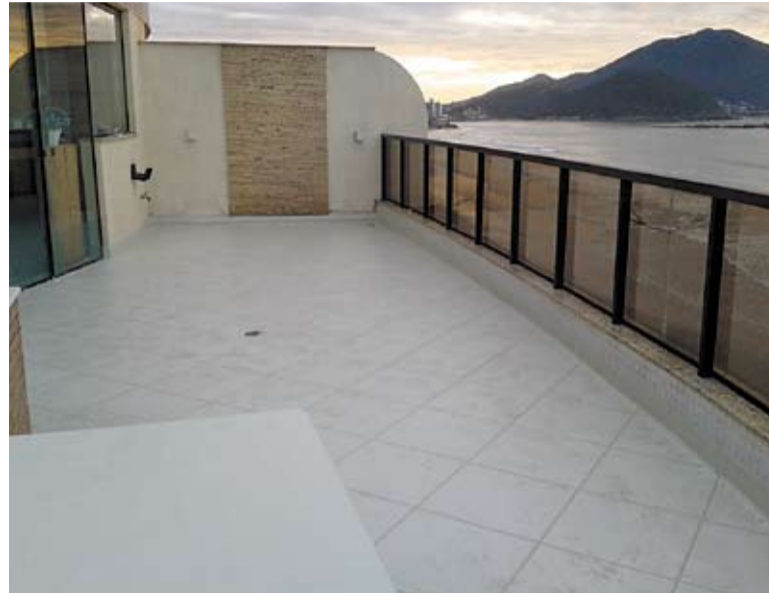
Cobertura no Residencial Ilha de Capri, em Navegantes: o morador levou dois anos para solucionar os problemas de infiltrações no imóvel
