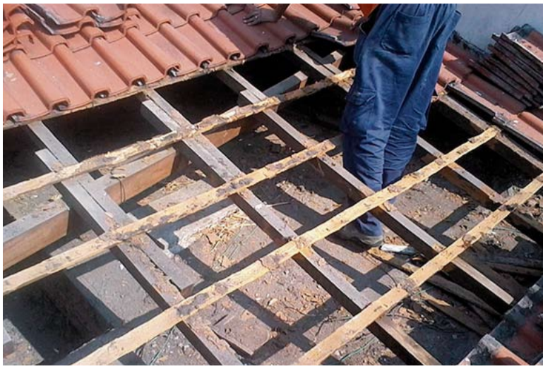
Infestação em telhados ou estruturas de contenção traz prejuízo para os condomínios
